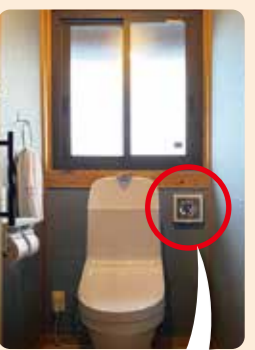
窓の右下の四角いのが問題の換気扇です。
